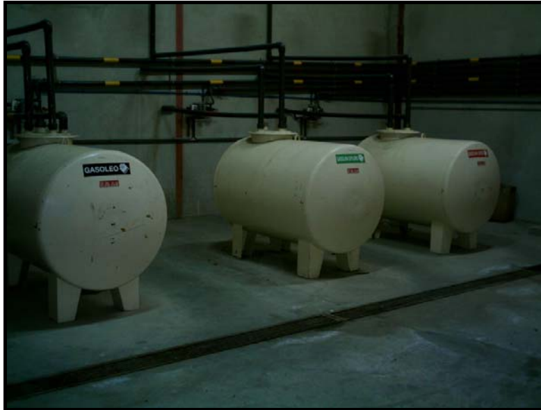
Imagen 5.2. Depósitos para recogida de Combustible, gasolina con y sin plomo y gasoil. Fuente: Propia (2003).
