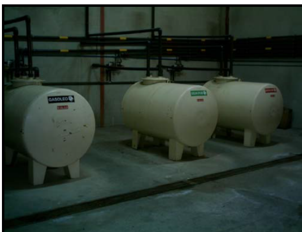
Imagen 5.6, 5.7 y 5.8. Sistema de extracción de combustibles por aspiración neumática (gasolina con plomo, sin plomo y gasóleo). Fuente: Propia (2003).
