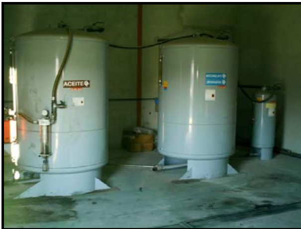
Imagen 5.11, 5.12 y 5.13. Sistema de extracción de líquidos por aspiración (aceite, anticongelante y líquido de frenos). Fuente: Propia (2003).
