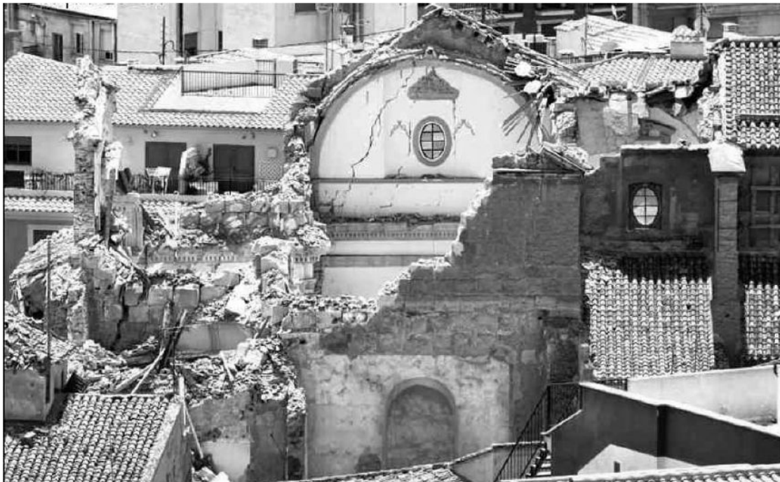
Figura 4. Iglesia de Santiago (Lorca): daños producidos por sismo Lorca (2011). Fuente: Plan Director para la recuperación del Patrimonio Histórico de Lorca (Murcia).
