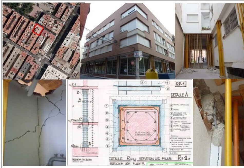
Figura 3. Edificio Venecia (Lorca) Grado de intervención: G4 (medio). Fuente: Juan Antonio Santacruz Alemán (Informe de reparación) y Juan Roldan Ruiz (Detalle constructivo Rp-1A).
